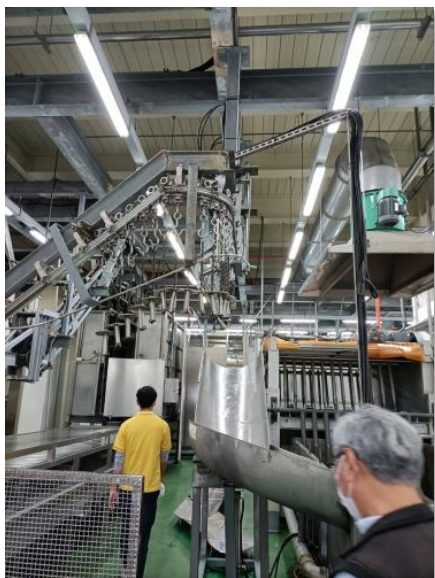
▲屠體軌道自動推送設備
